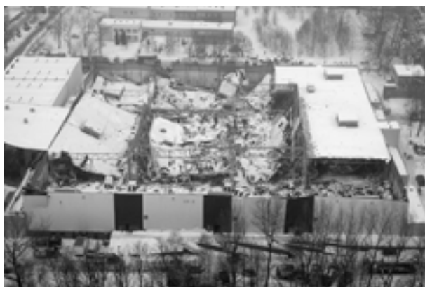
Fotografia 4. Widok zawalonej hali w Chorzowie
