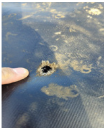
Ryc. 12. Uszkodzenie mechaniczne powstałe w wyniku uszkodzeń mechanicznych w wyniku nierównego podłoża
